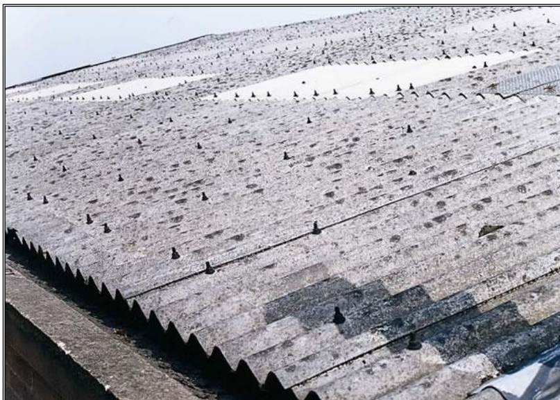
Rysunek 1. Dach pokryty azbestową płytą falistą
