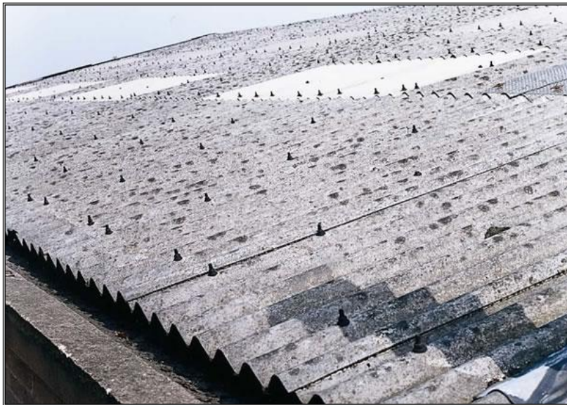
Rysunek 1. Dach pokryty azbestową płytą falistą
