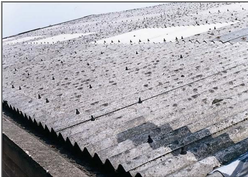
Rysunek 1. Dach pokryty azbestową płytą falistą
